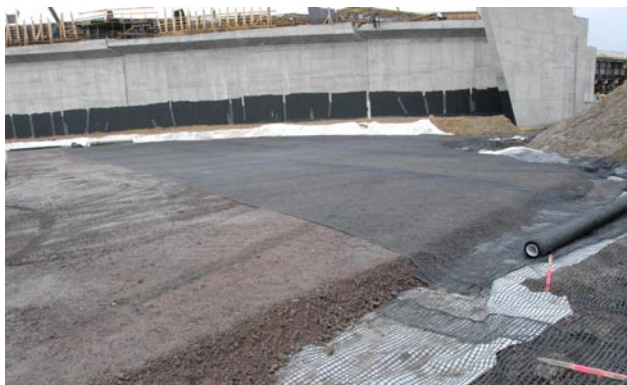
Fot. 4. Zasyпка przyczółka obiektu WD 466.2 w ciągu A1 od strony południowej. Konstrukcja materaca analogiczna jak na fot. 3
