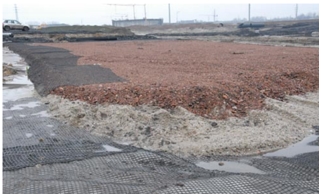
Fot. 3. Wzmocnienie podłoża (geosiatka na geowłókninie), na nim warstwa pospółki i materac
