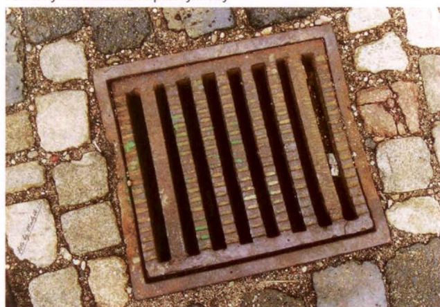
Fot. 4. Wpust punktowy niecki powierzchni parkingowej
