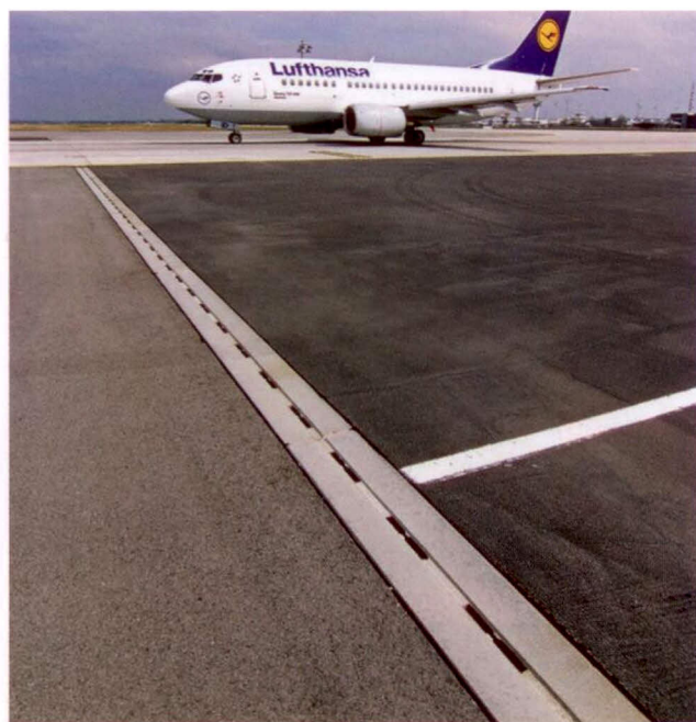
Fot. 5. Szczelina rynny odwodnienia powierzchniowego równi terminali lotniskowych
