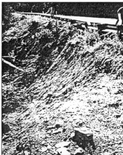
Fot. 6. Osuwisko skarpy drogowej w fazie początkowej.
